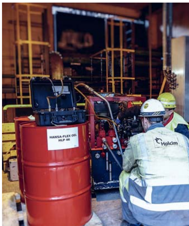
Das externe Spülaggregat (rot) ist hier mittig-links im Bild im Hintergrund zu sehen.
