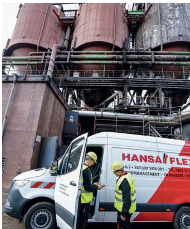
Eine komplette Spülung des gesamten Rohrleitungssystems empfiehlt sich bei einer Neuinbetriebnahme oder nach Revisionen. Denn Verunreinigungen, die bereits zu Beginn bestehen, ziehen sich über die gesamte Lebensdauer der Anlage.
